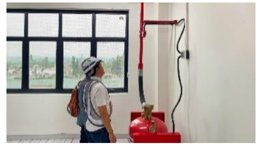
FM200 Fire Suppression System PT. WIKO Gedung Tbk Stasiun Kereta Cepat KCIC Padalarang
