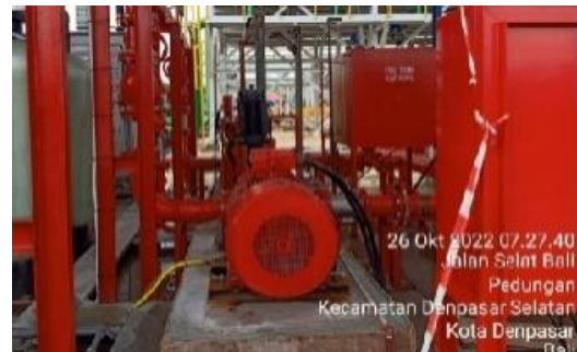
Fire Protection System Package PT. Rekadaya ElektriKa – PLTG Pesanggaran Bali
