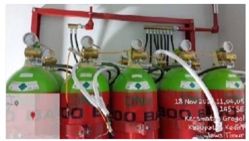
Inergen Fire Suppression System PT Wijaya Karya (Persero) Tbk Bandara Dhoho Kediri
